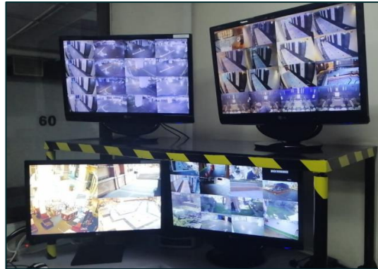
MONITORES CCTV EN SALA CONTROL
