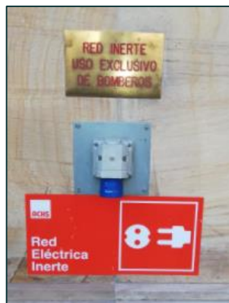
RED INERTE TOMA EXTERIOR
