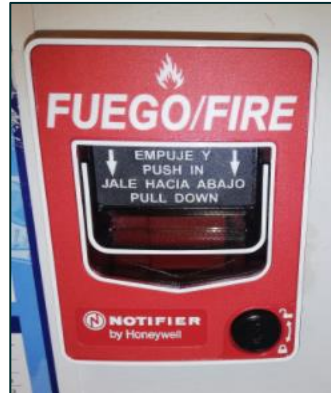
PALANCA DE INCENDIO
